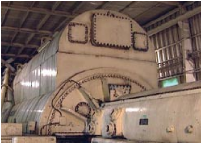
Одна из огромных турбин KCP&L, использующихся для выработки электроэнергии
