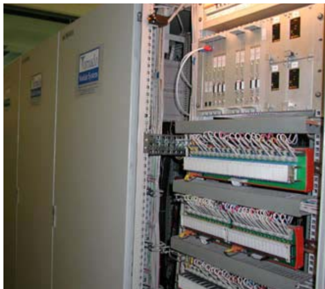
Шкафы контроллеров ПТК «Торнадо»
