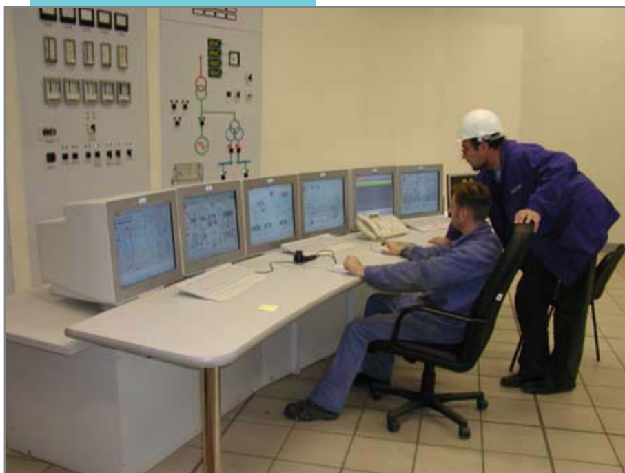
Автоматизированное рабочее место операторов на базе InTouch
